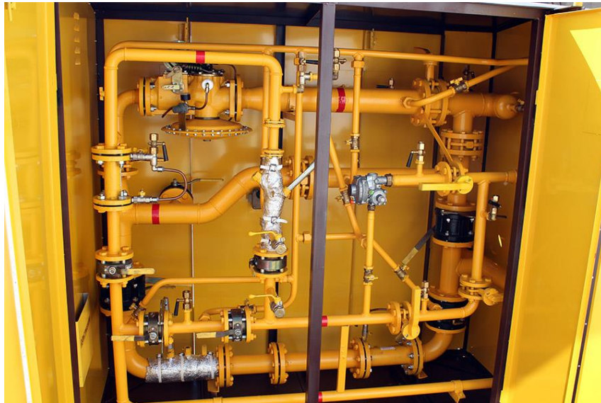
Рис. 2. Шафовий газорегуляторний пункт (ШГРП)
