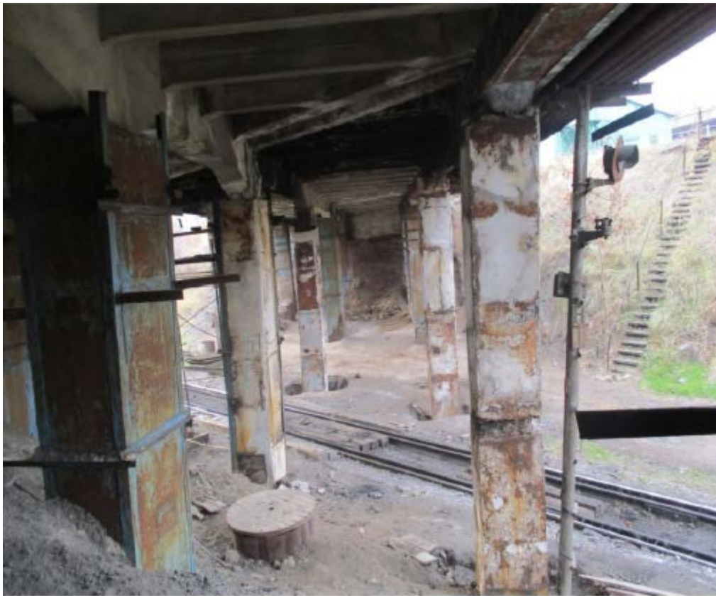
Рис. 3. Загальний стан конструкцій шляхопроводу
