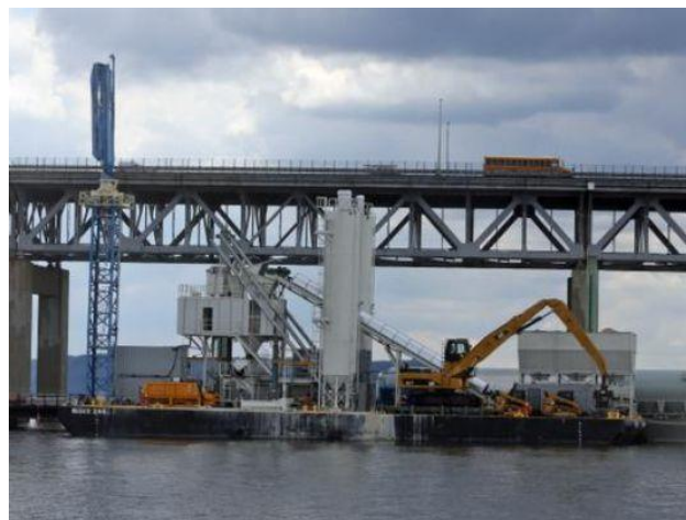
Рис. 8. Бетонозмішувальний завод фірми Batchtec
