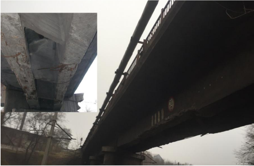
Рис. 3. Пошкоджені балки прогонової будови.
