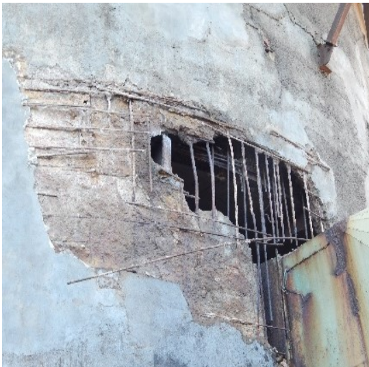
Рис. 4. Наскрізне руйнування стовбура, відсутність горизонтальної арматури
