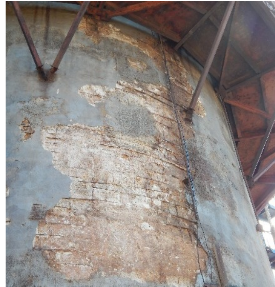
Рис. 3. Відсутність захисного шару бетону
