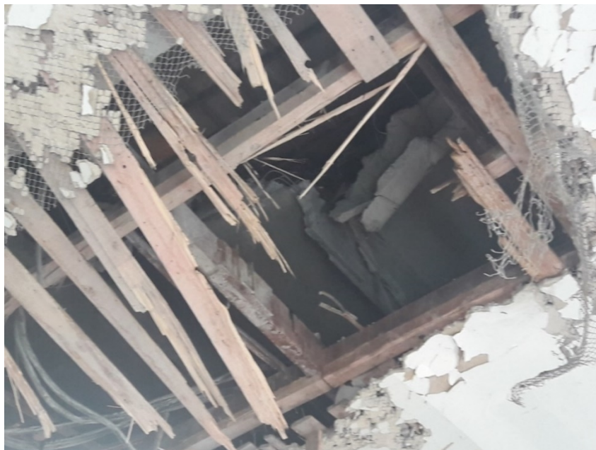
Рис. 2. Зруйновані плити покриття адміністративної будівлі внаслідок артилерійського обстрілу. Фото 2. Д. Журавський, 2022 Fig. 2. Destroyed roof slabs of an administrative building due to artillery fire. Photos 2 by D. Zhuravskiy, 2022
