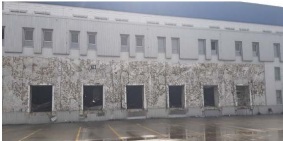
Рис. 4. Загальний вигляд пошкодженого об'єкту (вигляд з боку пошкодженого адміністративного корпусу). Автор фото Доброхлоп М.І.
