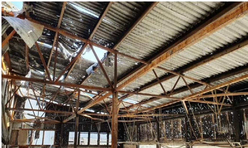
Рис. 3. Конструкції будівлі пошкоджені різними аспектами вибухових впливів. Автор фото Олександр Глітін
