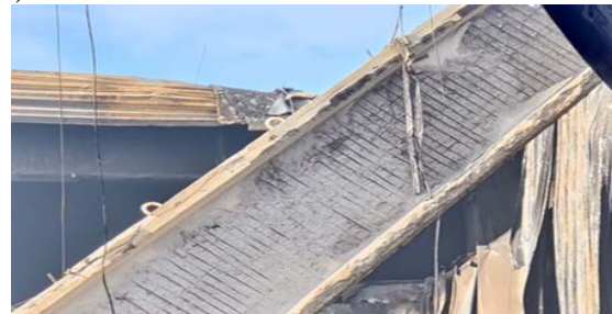
Рис. 9. Руйнування захисного шару балки. Автор фото Доброхлоп Є. Fig. 9. Destruction of the protective layer of the beam. Photo by Dobrokhlop Ye
