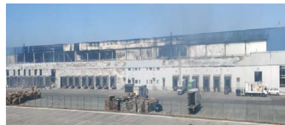
Рис. 2. Загальний вигляд пошкодженого об'єкту (вигляд з південної сторони). Автор фото Доброхлоп М.І.
