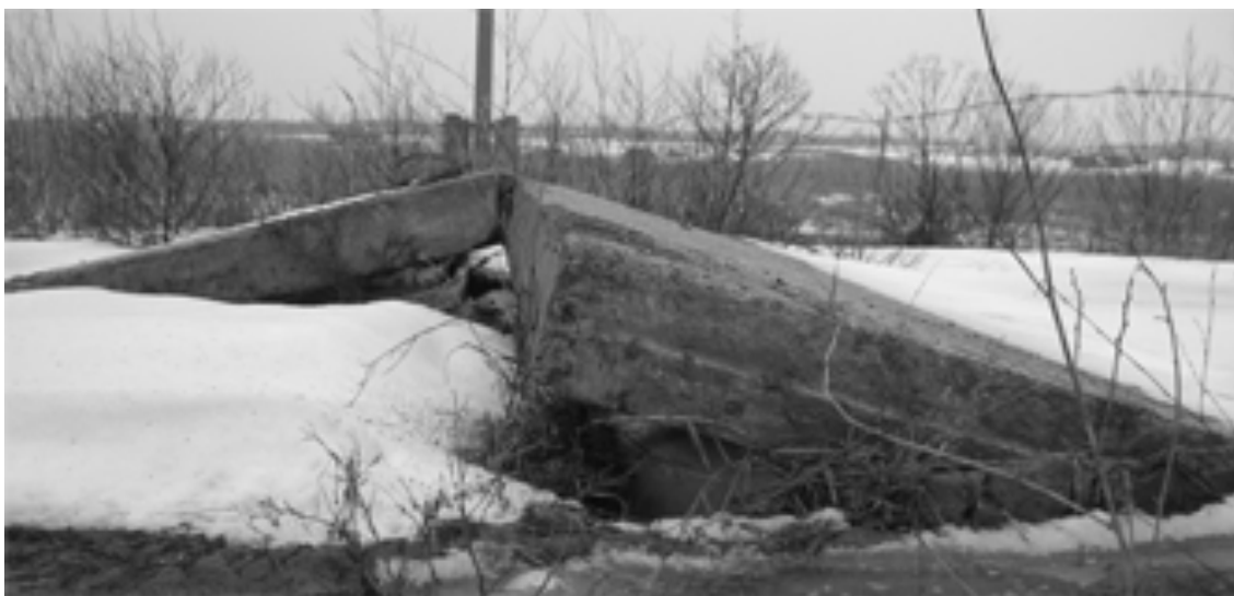
Рис. 1. Результат впливу стиснення земної поверхні на бетонне покриття дороги
