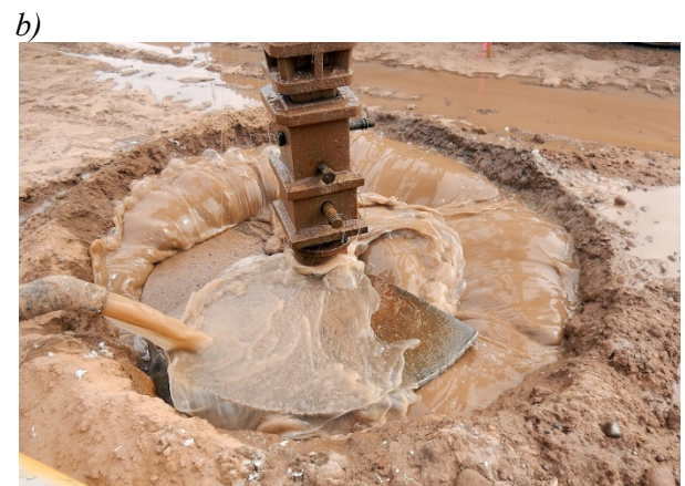
Рис. 2 Буронабивні палі під захистом глинистого розчину [7]: a – технологія виготовлення; b –приклад застосування; 1 – монтаж ротора, подача розчину; 2 – буріння свердловини з промиванням; 3 – встановлення арматурного каркасу; 4 – заповнення свердловини бетонною сумішшю; 5 –формування оголовка палі.
