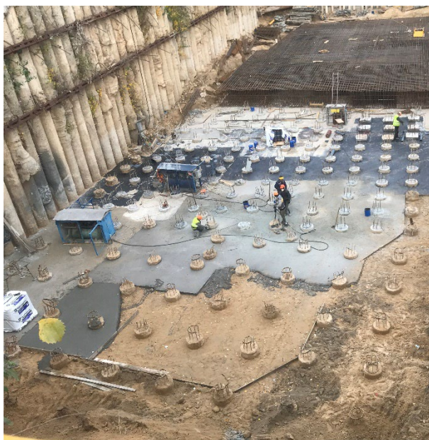
Рис. 8 Застосування буронабивних паль в якості огорожуючих та фундаментних конструкцій на майданчику будівництва споруди з підземним паркінгом по пр. Перемоги, 42 у м. Києві
