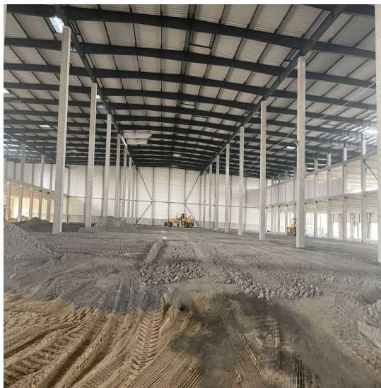
Рис.5. Влаштування піщаної основи товщиною від 1,5 – 4,7м: а – влаштування основи та її ущільнення котками з зубчастими вальцями; б – влаштування основи та її ущільнення котками з гладкими вальцями; с - втрамбування шару щебня в насипну частину; d - укладання та ущільнення щебенево – піщаної суміші, основного шару під промислову підлогу.
