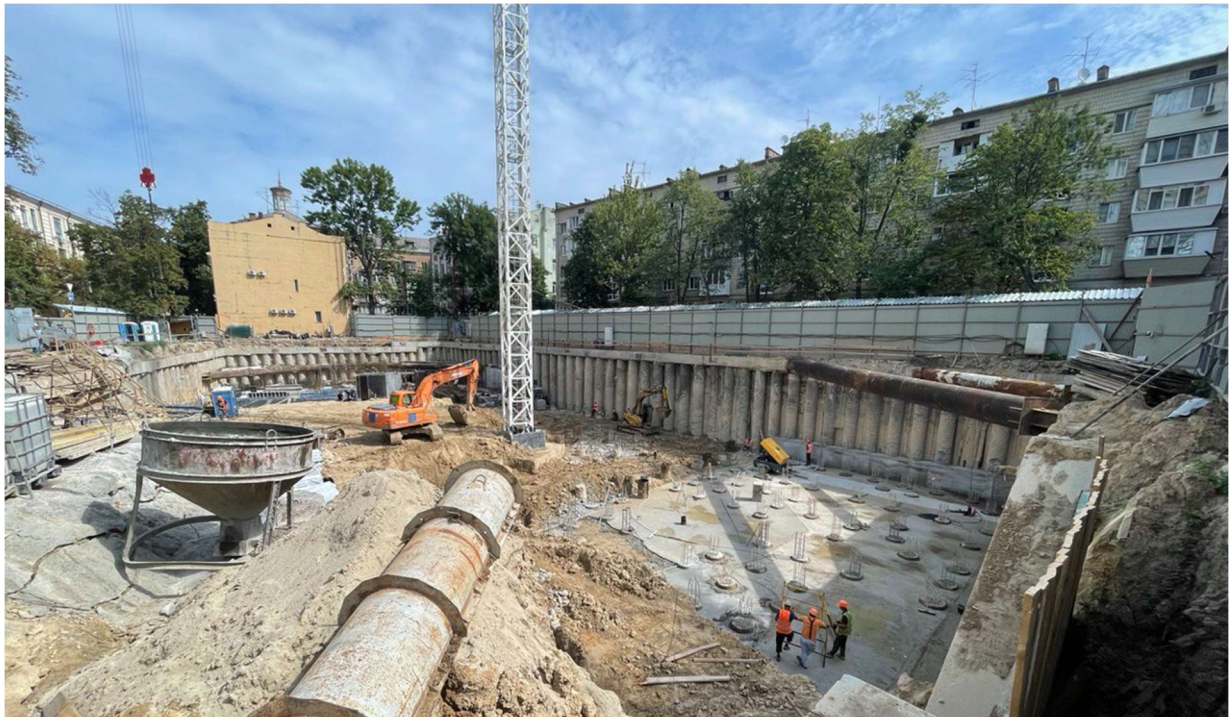
Рис.2. Фото ділянки будівництва на етапі влаштування фундаментної плити. Fig.2. Photo of the construction site at the stage of installation of the foundation slab.
