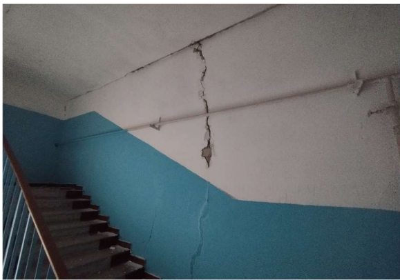
Рис.3. Тріщина стіни сходової клітини.
